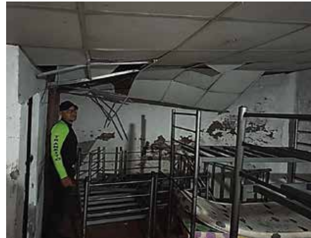
Figura 6. Deterioro de instalaciones - CDIT - Ibarra, 2022 Elaborado por: GOT, 2023
